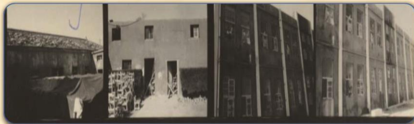
建物損壞情況二
