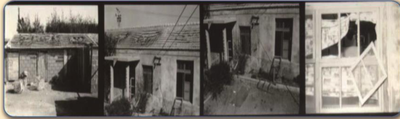
建物損壞情況一
